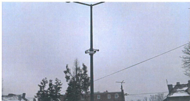
Fot. Zainstalowany monitoring (mat. MZBM Tychy)
