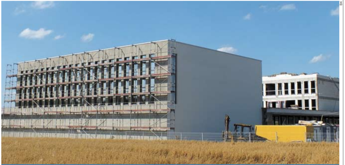
Budowa szkoły w dzielnicy JUW-e ma zakończyć się w styczniu przyszłego roku.
