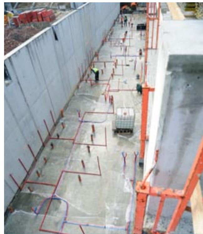
Wnętrze parteru trybuny północnej (od strony domków jednorodzinnych). Widoczna instalacja wodna doprowadzająca wodę do przyszłych pomieszczeń szatniowych obsługujących sztuczne boisko.
