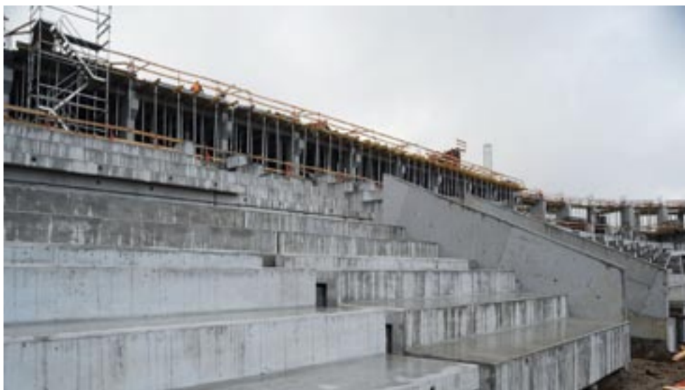
Wykonawca rozpoczął montaż prefabrykatów konstrukcji trybun, na których będą zamontowane krzeselka. Po prawej widać również tunel, który będzie prowadził z szatni na murawę stadionu.
