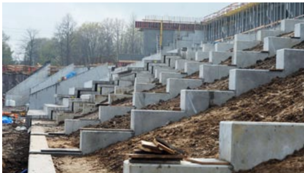
Nasyp ziemny i belki zębate, na które usadawiane są prefabrykaty pod krzeselka.
