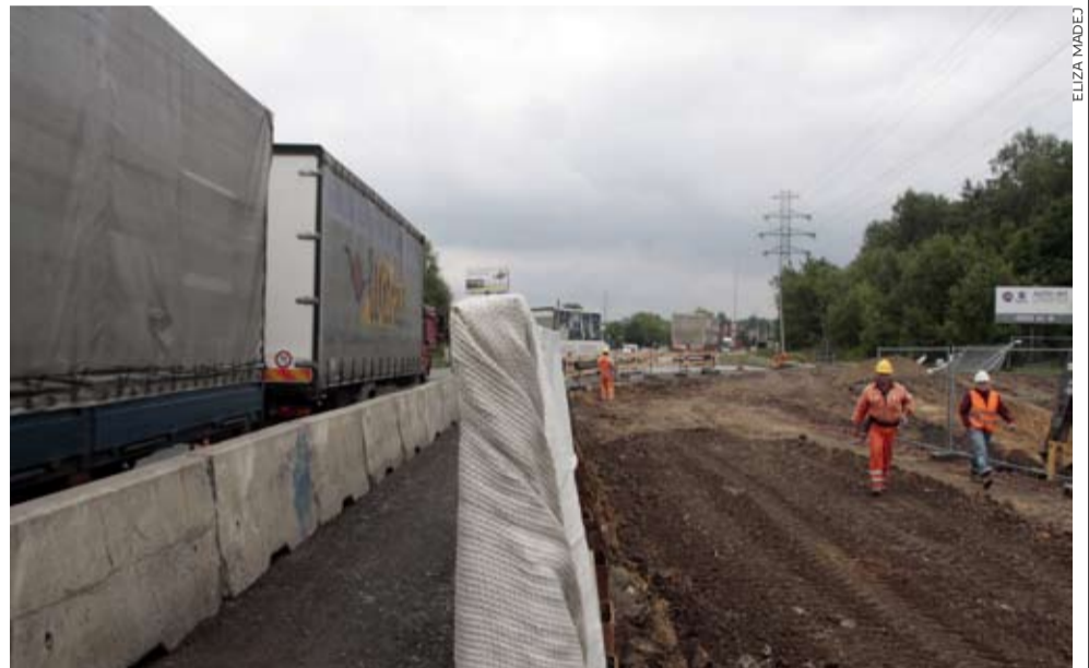
Na sierpień zaplanowano m.in. budowę fundamentów muru oporowego na wiadukcie nad al. Niepodległości, kontynuowane będą również roboty konstrukcyjne na przejściu podziemnym w rejonie ul. Edukacji.
